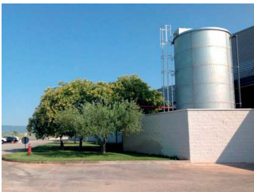
Dipòsit de reserva d'aigua
