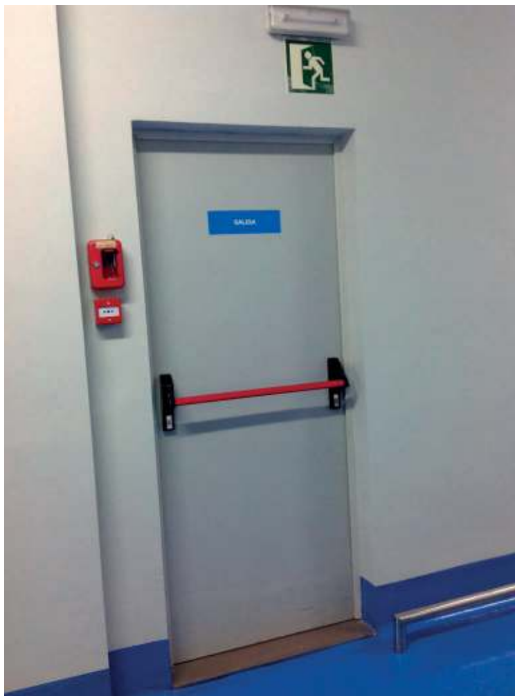
Il·luminació d'emergència sobre porta d'evacuació
